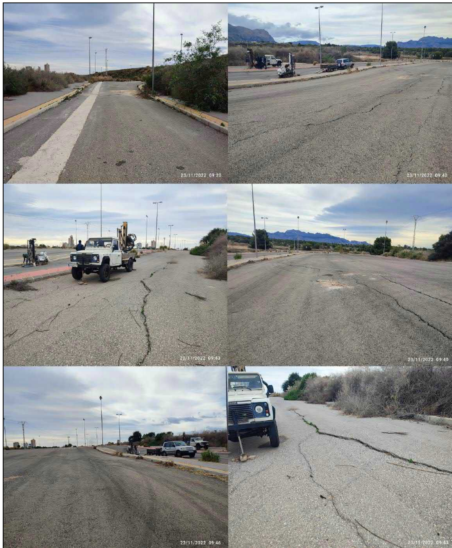
Figura 2: Hundimientos del firme de calzada y losas de acera en la parte situada al este de la urbanización Benipoli.
